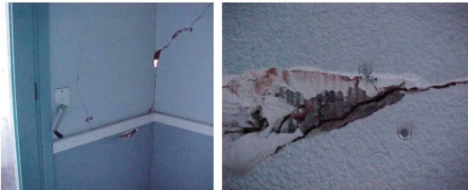
Fig. 3: Agrietamientos en las paredes del edificio dañado por un vaciado incorrecto que se llevó a cabo en un solar medianero.
