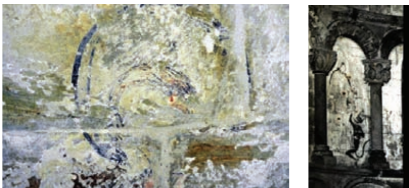
Fig. 24 y 25: Detalles de las evidencias encontradas de pinturas murales en la cabecera de la iglesia.
