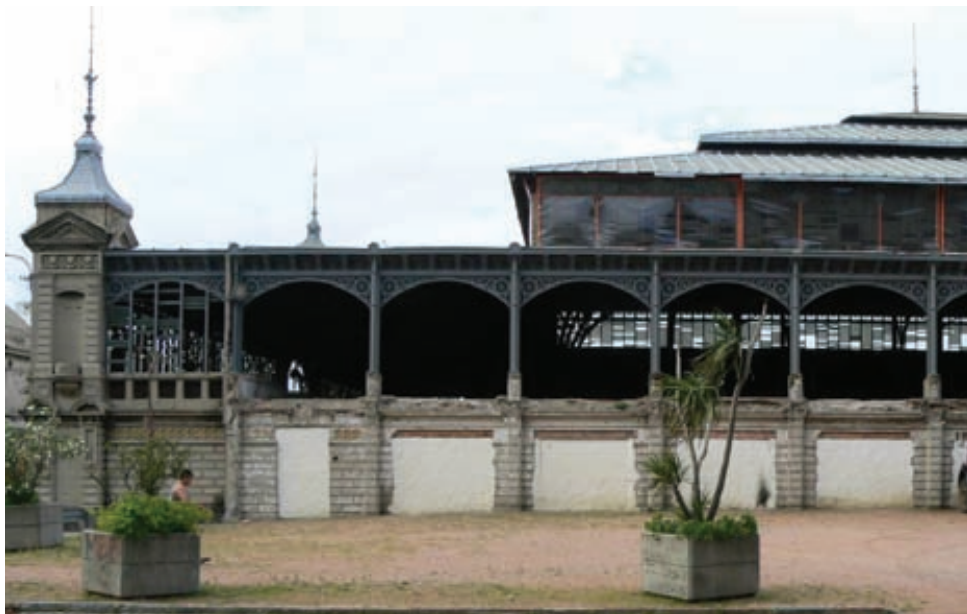
Fig. 6. Estado general fachada Martín García
