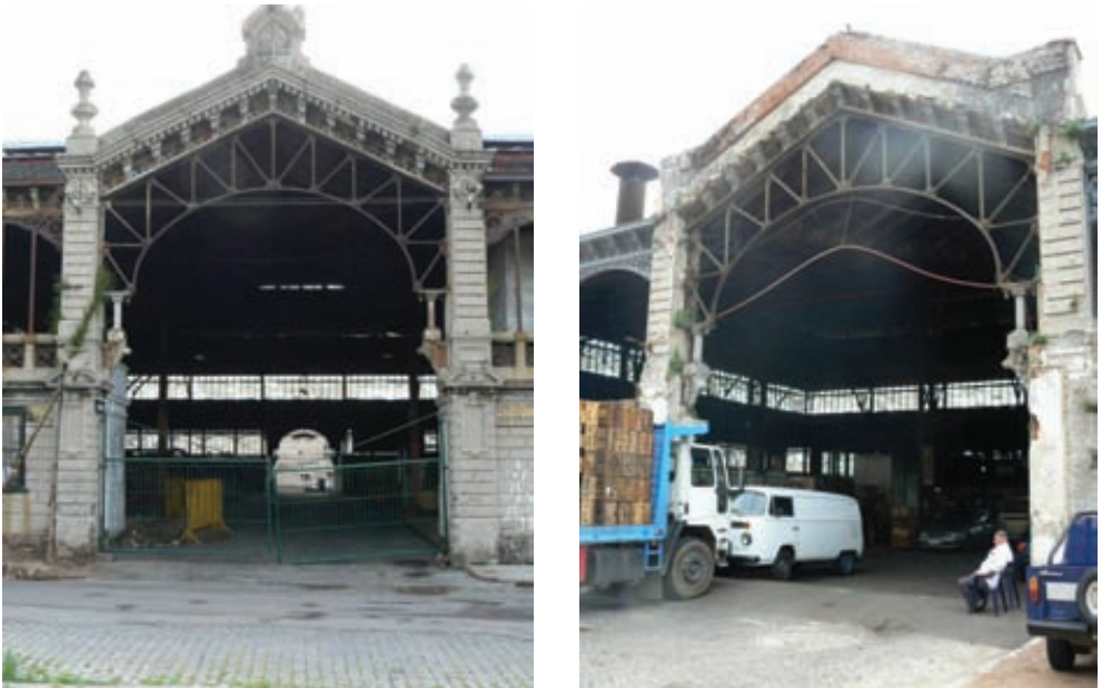
Fig. 9. Puertas acceso rodado fachada trasera (C/Valle Inclán) y lateral (C/Martín García) cuya ornamentación ha desaparecido por la construcción de edificio adosado.
