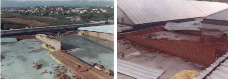
Fig. 6: Destrucción de una cubierta por efecto de la acción del viento y a causa de una incorrecta concepción del anclaje de la estructura portante.
