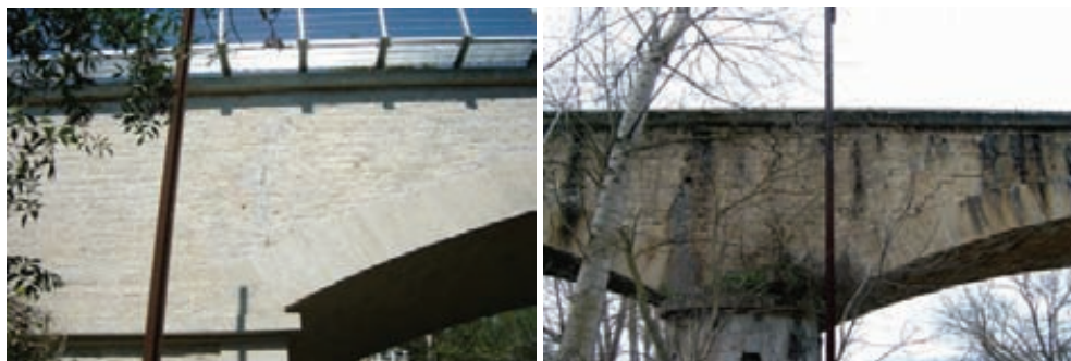
Fig. 10. Fisuras en tímpano tanto sobre pila como sobre riñones de bóveda. La parte inferior muestra el estado final.
