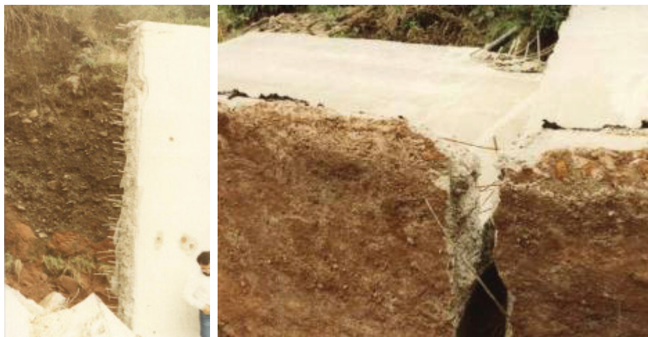
Fig. 4: Colapso de un depósito de hormigón armado por incumplimiento de las condiciones de equilibrio.
