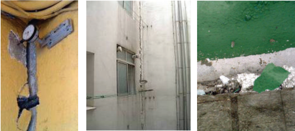
Fig. 2: Desplazamientos en el edificio afectado: Se midieron desplomes de 7 cm y descensos de 5 cm.
