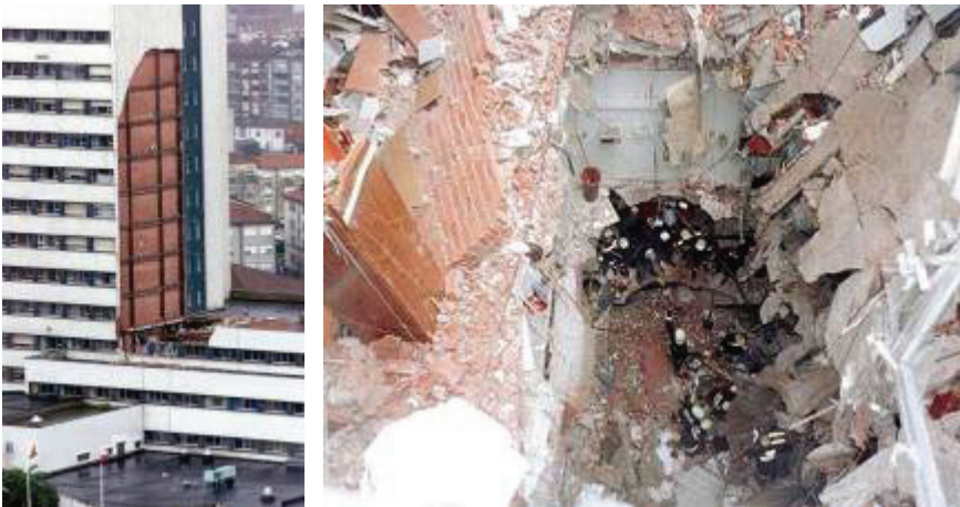
Fig. 7: Derrumbe de la fachada de un hospital y colapso de los forjados sobre los que cayeron los escombros.
