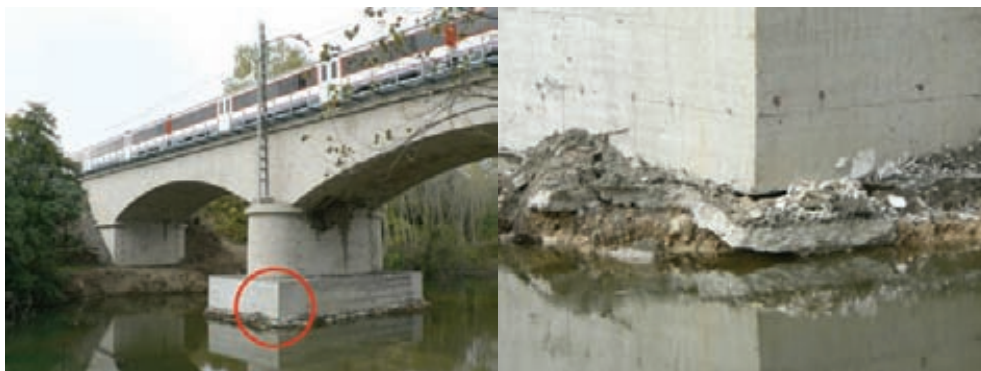
Fig. 15. Aspecto final de la obra. En la foto de detalle se muestra la consecuencia de un acabado defectuoso.
