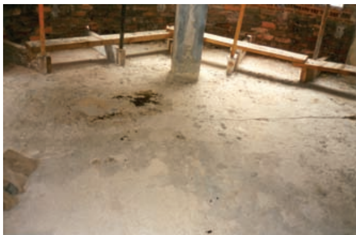
Fig. 5. Grieta en voladizo de piso de planta 1ª.
