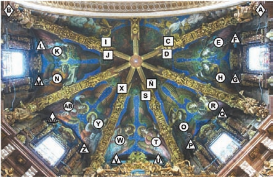
Fig 2. Posición de todos los sensores instalados en el intradós de la cúpula. Las letras dentro de un círculo representan los colocados en la pared gótica, dentro de un triángulo los colocados en las paredes verticales y los triangulares y romboideos los ambientales.
