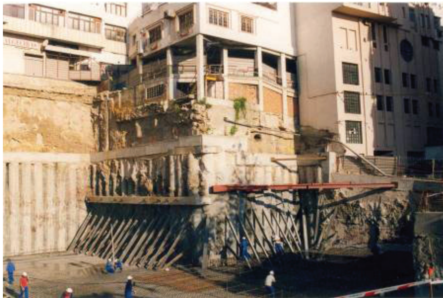
Fig. 1: Edificio de viviendas junto a un vaciado de tierras mal planteado: Durante la ejecución de las obras, el inmueble existente mostró importantes anomalías; los daños que aparecieron provocó la alarma los vecinos y que éstos fueran desalojados por algún tiempo.
