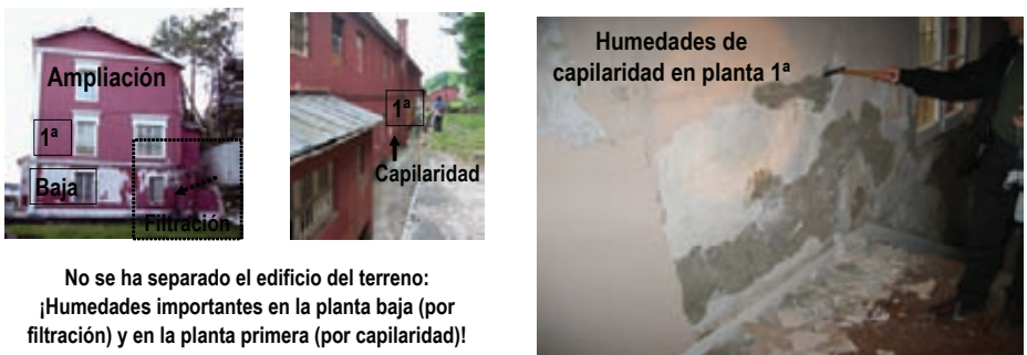
Fig. 12: Las humedades existentes en este edificio de oficinas objeto de rehabilitación fueron diagnosticadas en la fase de reconocimiento.
