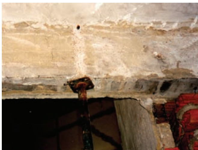
Fig. 4. Tipología de grietas en vigas.
